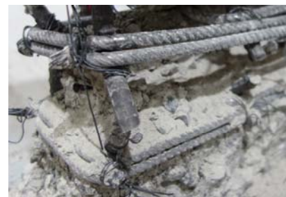
図 3 袖壁脚部の損傷状況 (S15A04)
