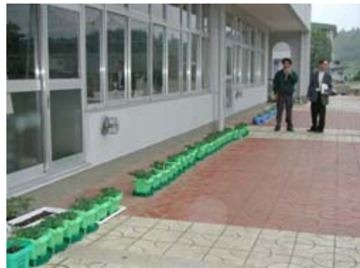
校舎・南側地盤変状
