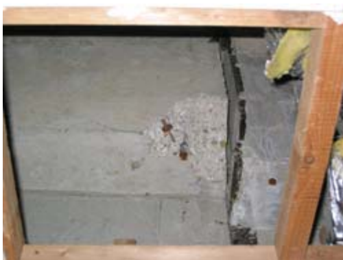
南北校舎間のエキスパンション・ ジョイントの衝突
