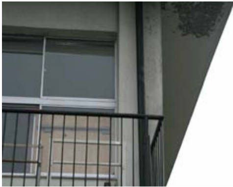
南校舎・2F 隅柱 (縦方向ひび割れ)
