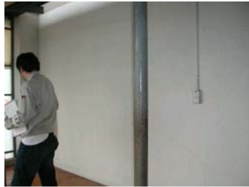
張間方向 1F 耐震壁 (せん断ひび割れ発生)
