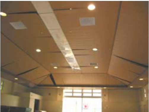
柔剣道場 (天井板の落下)
