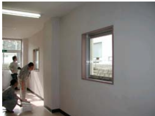
第二校舎・開口付き増設壁 (軽微なせん断ひび割れ)
