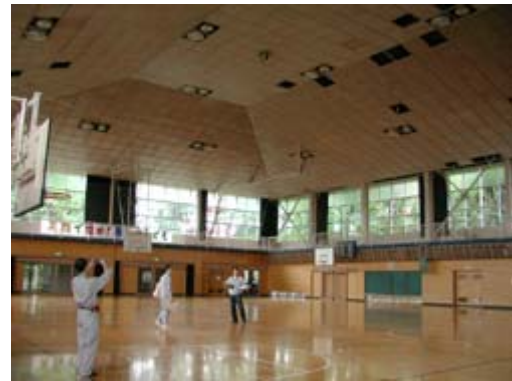
体育館・内部 (天井のグラスウール材落下)
