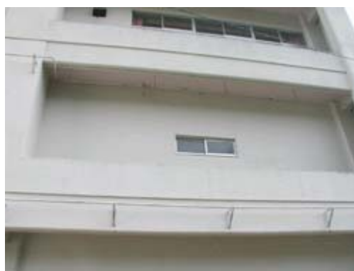
2F開口付き増設壁 （せん断ひび割れ発生）
