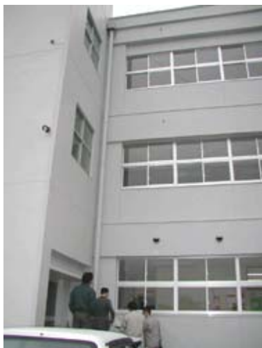
北面柱（1F～3F）の袖壁補強 （曲げひび割れ発生）
