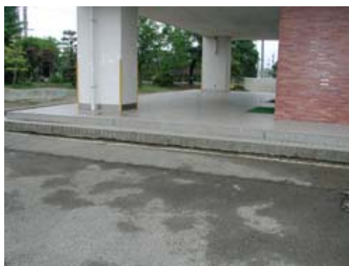
北側の土間コンクリートの沈下 及び鉄板巻き立て補強した柱
