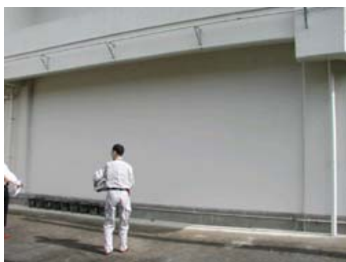
北面1F・RC増設壁 （せん断ひび割れ・幅0.4mm発生）
