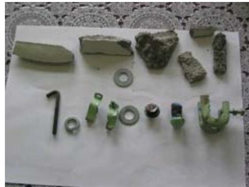
体育館天井及び周辺からの落下物
