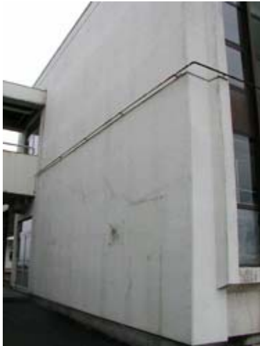
南棟妻壁 (せん断ひび割れ発生)
