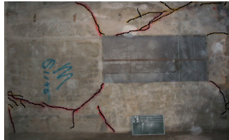
写真2 3階1通りB-C通り間の開口壁
