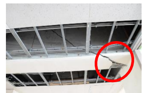
ねじれひび割れ
