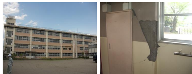
写真-1 南側立面全景 写真-2 雑壁の損傷状況
